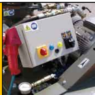
Cuadro eléctrico Electric control board
